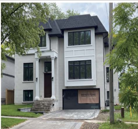
北約克豪華全獨立 已經开工 Don Mills /Sheppard E., 豪華兩層全獨立，約3900呎
