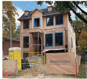
北约克豪华全独立 在建 Lawrence Ave/Bathurst St., 豪华两层全独立，约 4300 呎。
