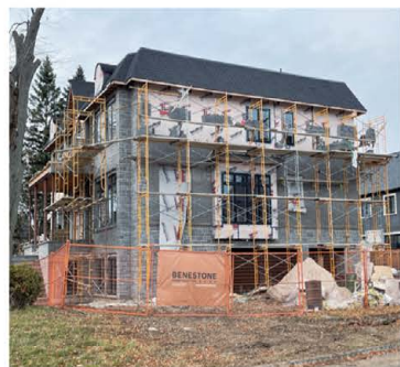
列之文山豪华全独立 在建 Yonge/King Rd., 豪华两层全独立，约 5200 呎。
