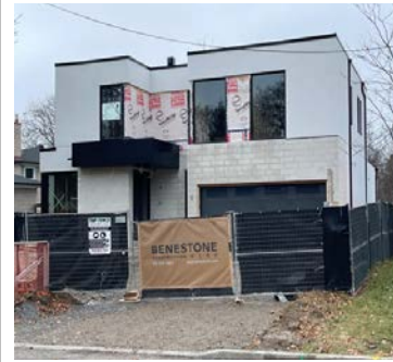
万景豪华全独立 在建 Markham Rd/Hwy7, 豪华现代两层全独立, 约 3500 呎.
