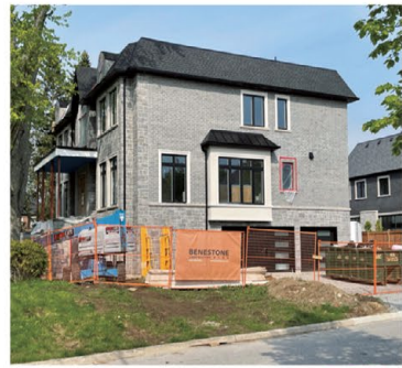
列之文山豪華全獨立 在建 Yonge/King Rd., 豪華兩層全獨立, 約 5200 呎.
