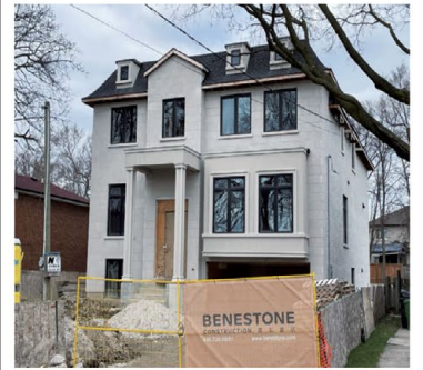
北約克豪華全獨立 在建 Lawrence Ave/Bathurst St., 豪華兩層全獨立, 約 4300 呎.
